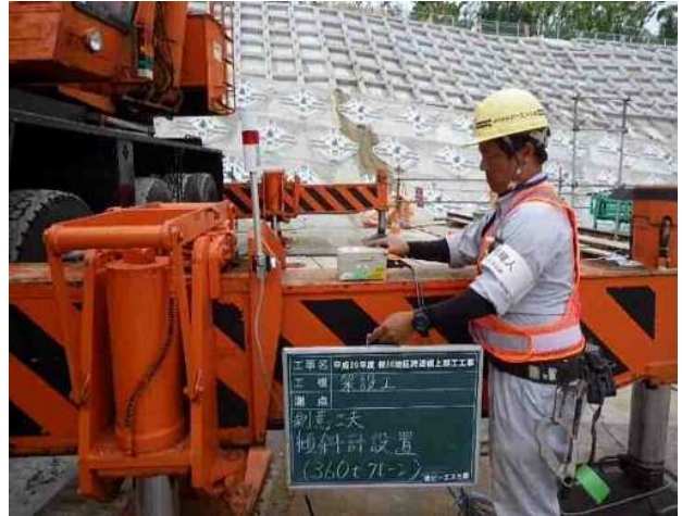
傾斜計（アウトリガーに設置）
