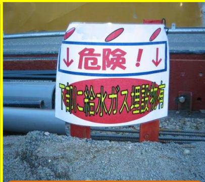
埋設管があることが分かるように表示している
