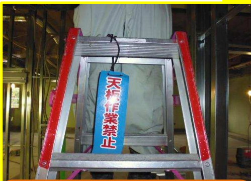
脚立に天板上で作業することを禁止する札を取り付けている
