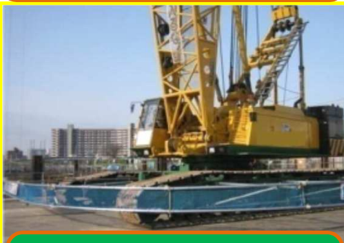
移動式クレーンの旋回範囲を柵で区画することにより明確にしている
