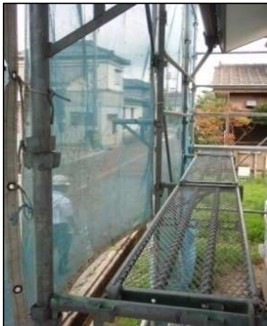
写真 メッシュシートあり (メッシュシートと作業床との間に隙間 ×)
