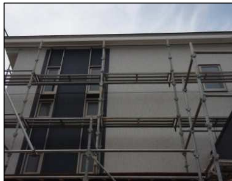
写真 手すりの逸脱 ×
