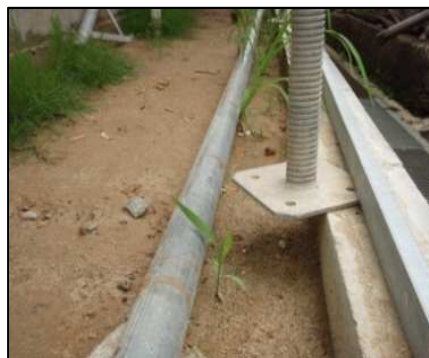
写真 設置位置不良 ×
