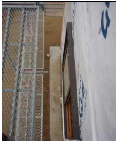
写真 躯体隙間養生なし ×
