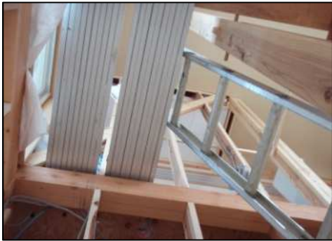
写真 上部及び作業床の固定なし ×
