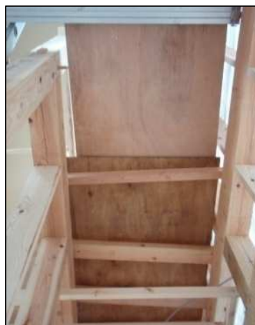
写真 開口部養生不備 ×
