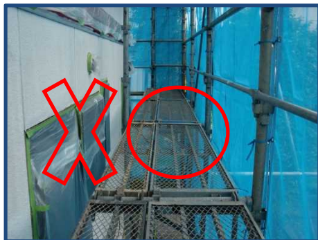
△ B邸改修工事(作業床○、建地とばし×)
