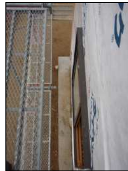
躯体隙間養生なし ×
