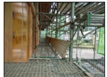
巾木(飛来落下防止)あり
