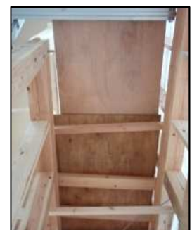
開口部養生不備 ×
