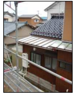
手すりの逸脱 ×
