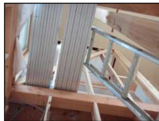
上部及び作業床の固定なし ×
