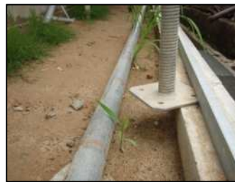
設置位置不良 ×
