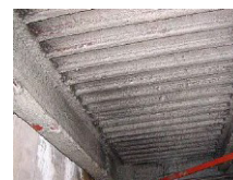
アスベスト含有吹付け ロックウール (鉄骨材の耐火被覆)
