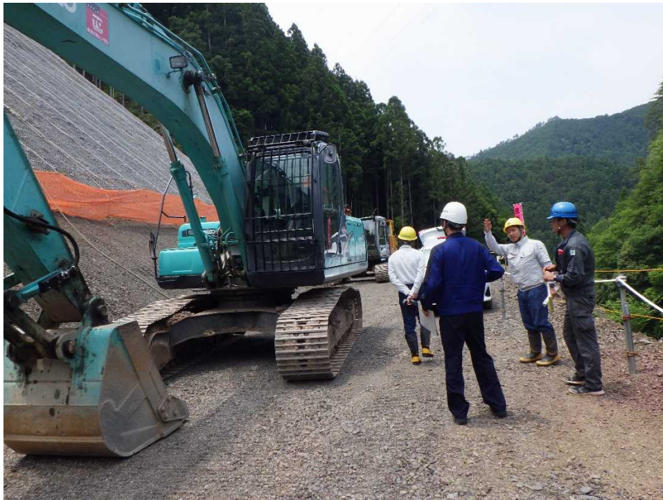
(坪内山腹工事現場に合同安全パトロールを実施) 現場における危険個所の確認及び改善方法について指導を行いました
