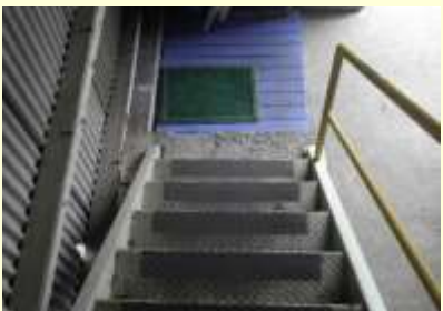
◆階段の滑り止めテープ
