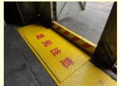
◆出入口段差の注意喚起
