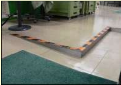
◆段差の注意喚起表示
