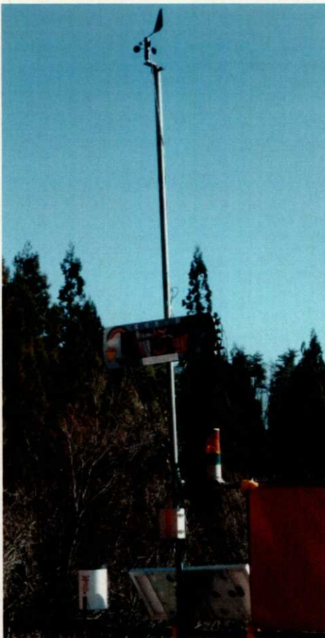
デジタル風速計の外観
