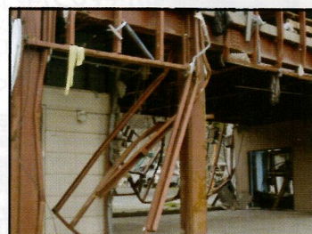
1階部分に津波被害を受けた鉄骨造建築物
