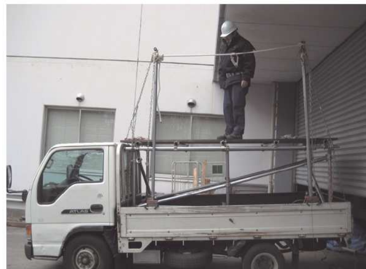
安全帯取付設備を設置した例
