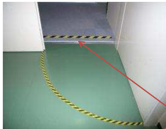
傾斜部分を明示
