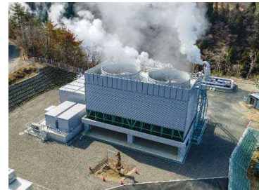
わいた第2地熱発電所
