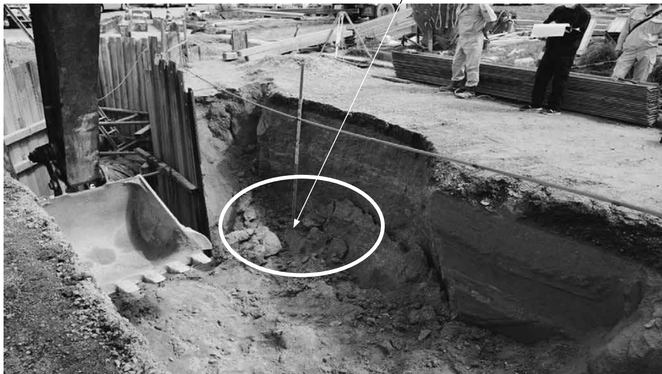
崩壊した土砂
