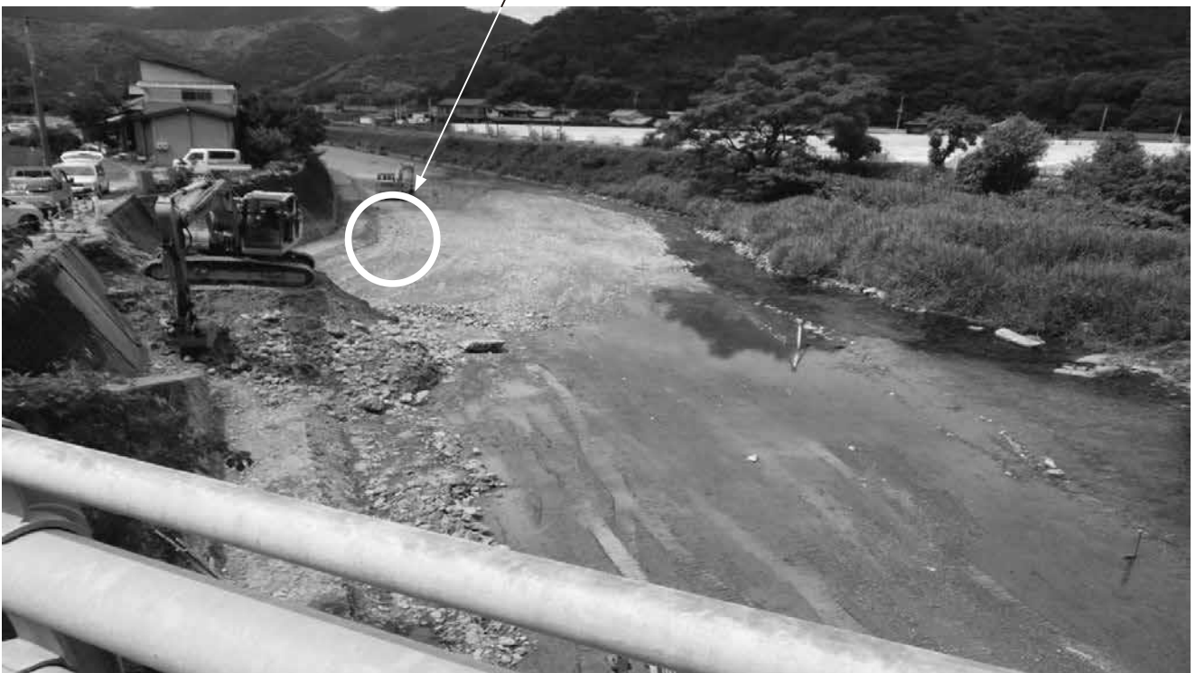
災害発生現場
