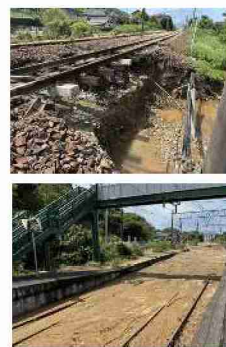
（肥薩おれんじ鉄道） 肥後高田駅近くの様子 （8/12 12時頃）
