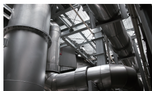
プラント配管
