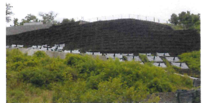
大矢崎地区地滑り災害
