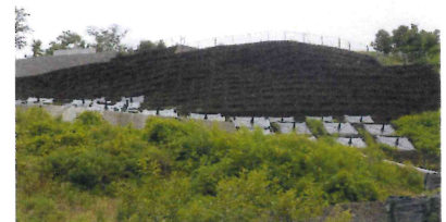
大矢崎地区地滑り災害
