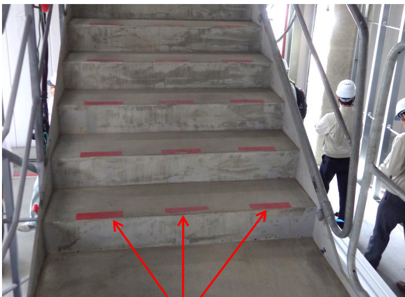
写真21【階段段差部分】
