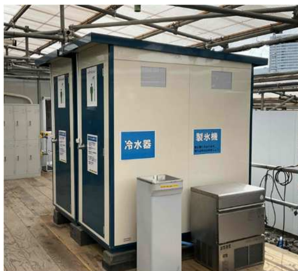
↑ シャワールーム、冷水器、製氷機の設置状況
