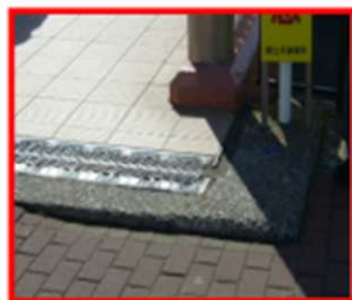
段差ができています
