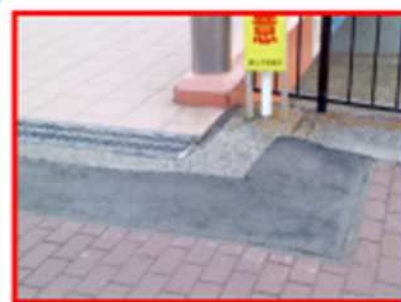
段差がアスファルトで埋まっている
