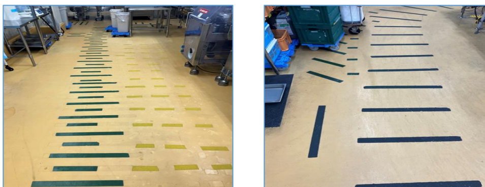
<滑り止めテープを貼り付けた箇所>
