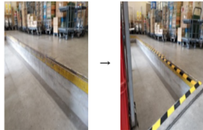
商品搬入口とバックヤード通路の段差にトラマークを表示し危険の見える化を図る
