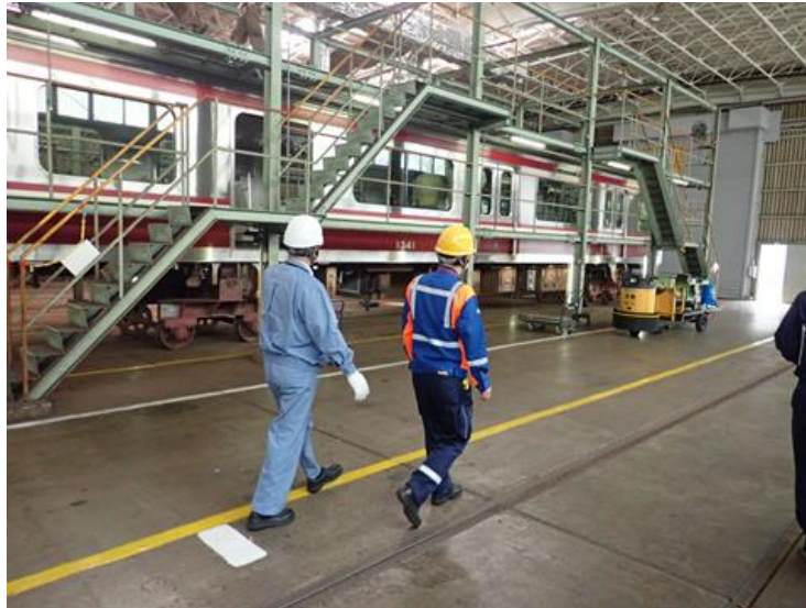
車両屋根部の専用作業台及び昇降階段の設置により、墜落災害防止に配慮しています。
