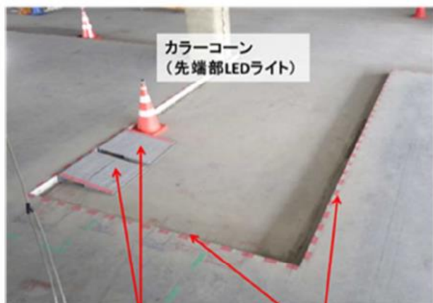
段差スロープ(鋼製板) 赤色のテープ
