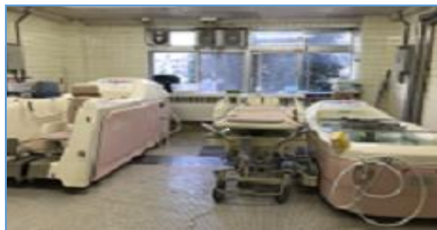
特殊浴槽の設備です
