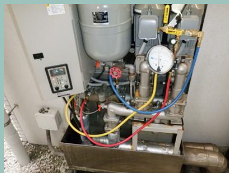
増圧給水ポンプ点検
