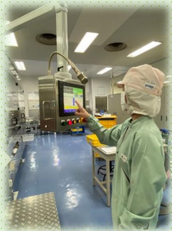
←医薬品 設備を起動している 写真です。
