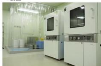
クリーンルーム
