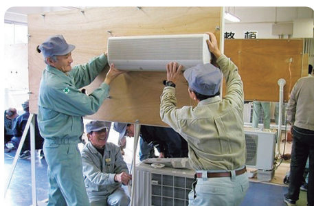
空調設備管理作業
