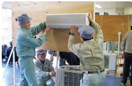
空調設備管理作業
