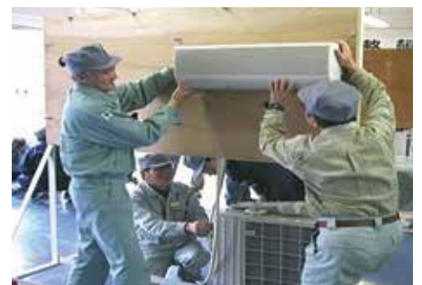
空調設備管理作業
