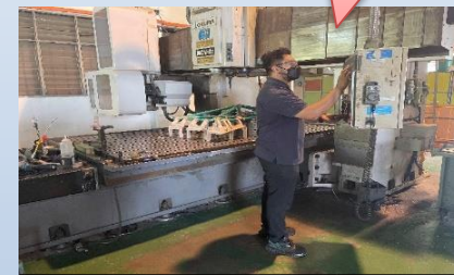
制御盤操作をしている元実習生
