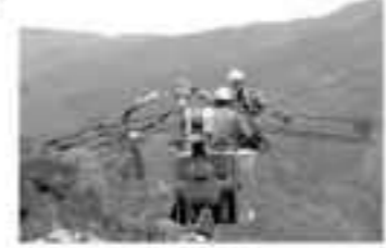
電柱や電線の新設・改修を手掛けるため高所での作業も多い
