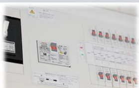
高圧用機器受配電機器 (ブレーカーや配電盤など)
