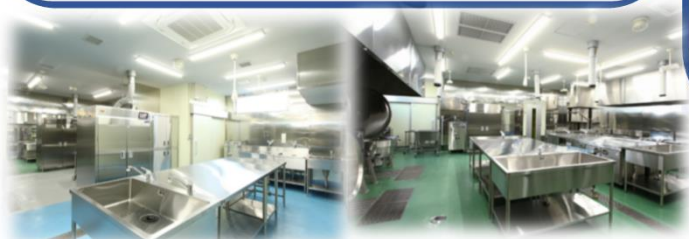
▲セントラルキッチン内（左：下処理室、右：調理室）▲
