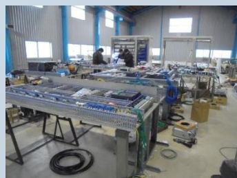
配線工場内風景
