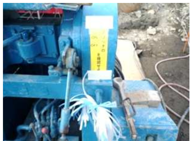
各掘削機にステッカーを掲示
