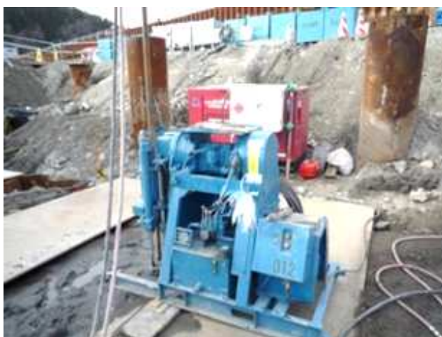
クラッチの ON,OFF 確認を注意喚起
