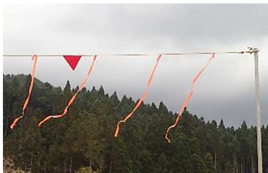
【架空線表示拡大写真】
