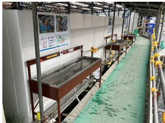
写真.AVA設置状況
