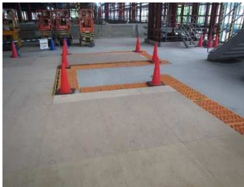
写真.段差明示
