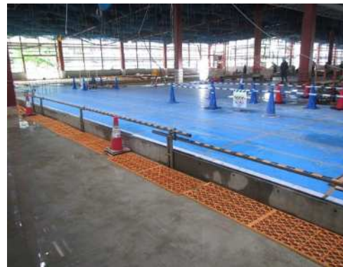
写真.段差明示と高所作業車強制停止措置
