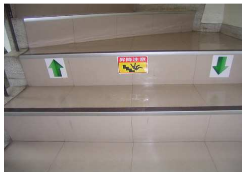
階段の通行方向表示と踏み外し防止の注意喚起ステッカー
