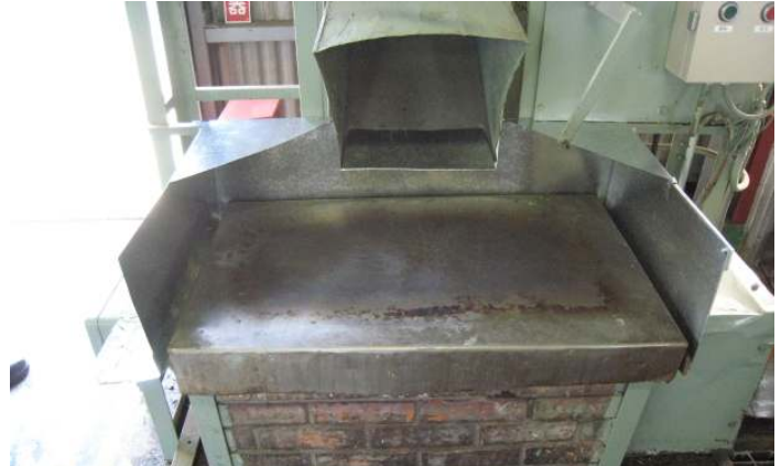
RAの改善例：外付け式局所排気装置にフランジを取り付け、より効率的に有害蒸気の排気を可能にした。
