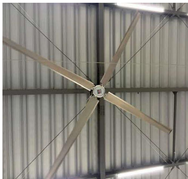
天井に設置された大型ファン
