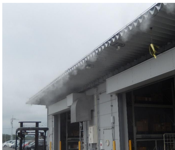
屋外倉庫のミストシャワー
