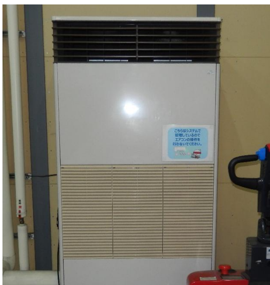
倉庫内に設置されたエアコン
