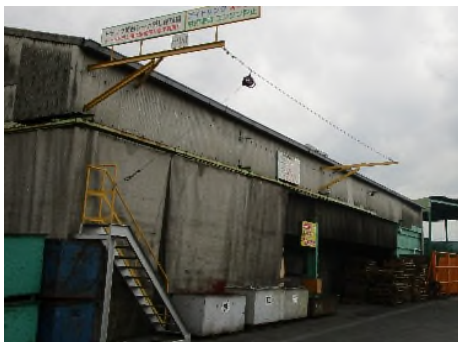
トラック運転手用の墜落制止用器具の取付設備
