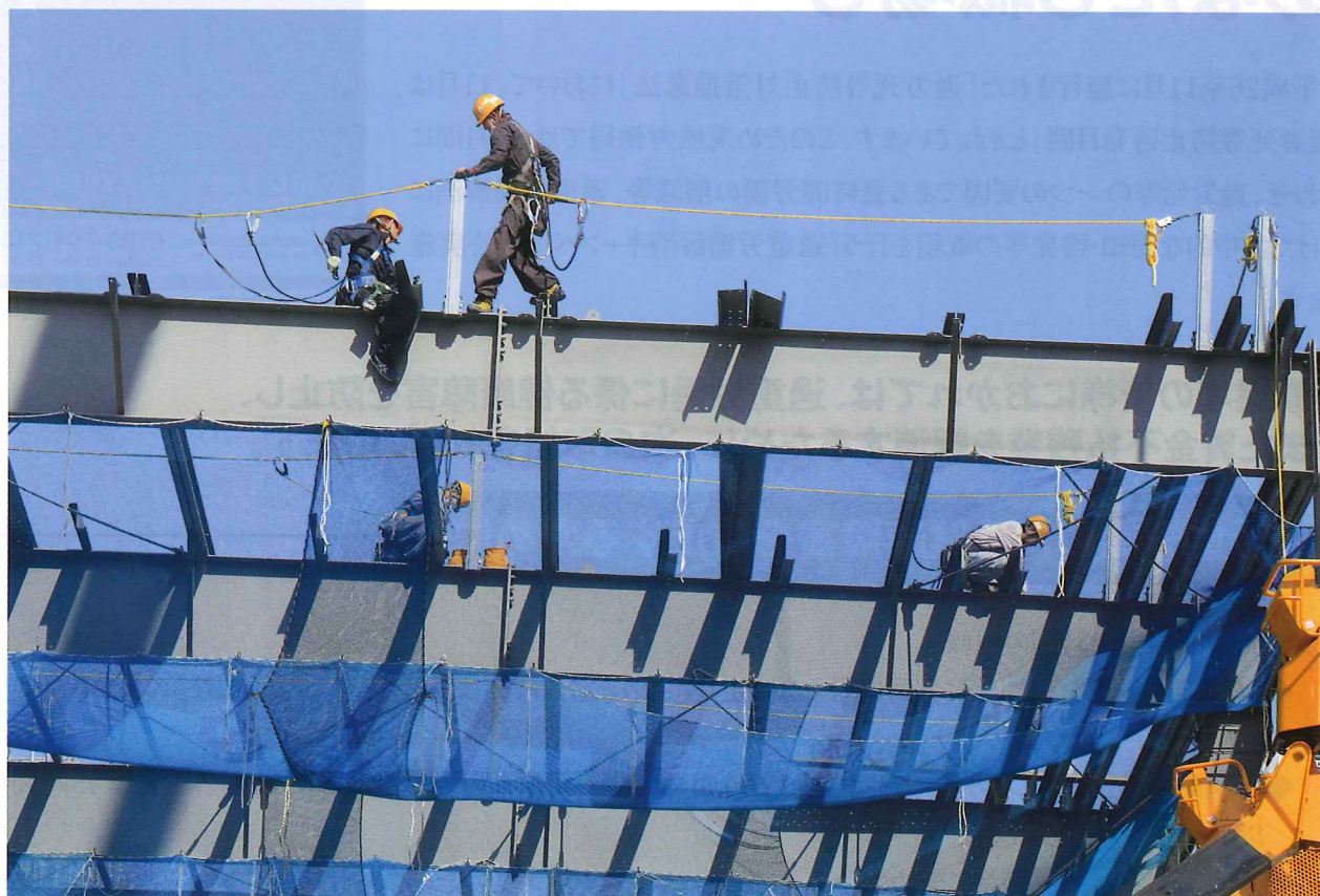
高所作業～安全帯着用ヨシ! 来年2月からはフルハーネス 先行ですね!!～ 写真提供者:水戸市 水谷 啓一氏 撮影協力:菅原建設(株)、(株)ヨシダ
