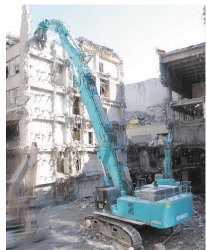
特定解体用機械のコンクリート圧砕機 コベルコ建機(株)製、同社提供
