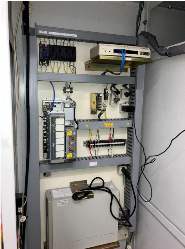
空調操作盤（盤内）
