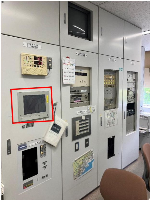
空調操作盤（盤面）
