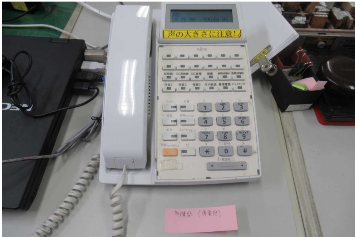
③ 停電用電話機（全体像、ボタン配置）
