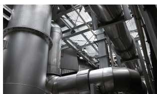
プラント配管
