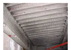
石綿含有吹付け ロックウール （鉄骨材の耐火被覆）
