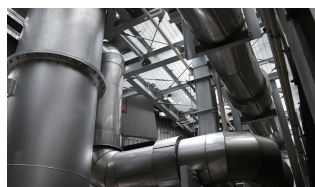
プラント配管
